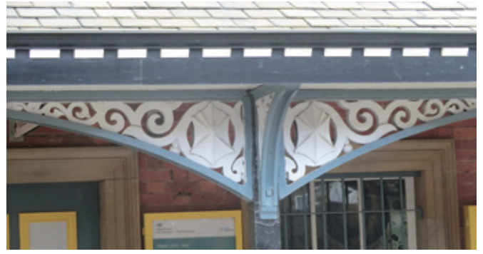
写真⑤ レインヒル駅のプラットホームの木製柱と鑄鉄梁の隅角部の構造。
