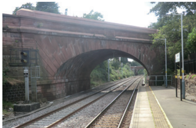
写真① スキュー・ブリッジをレインヒル駅のマンチェスタア行きホームから望む
